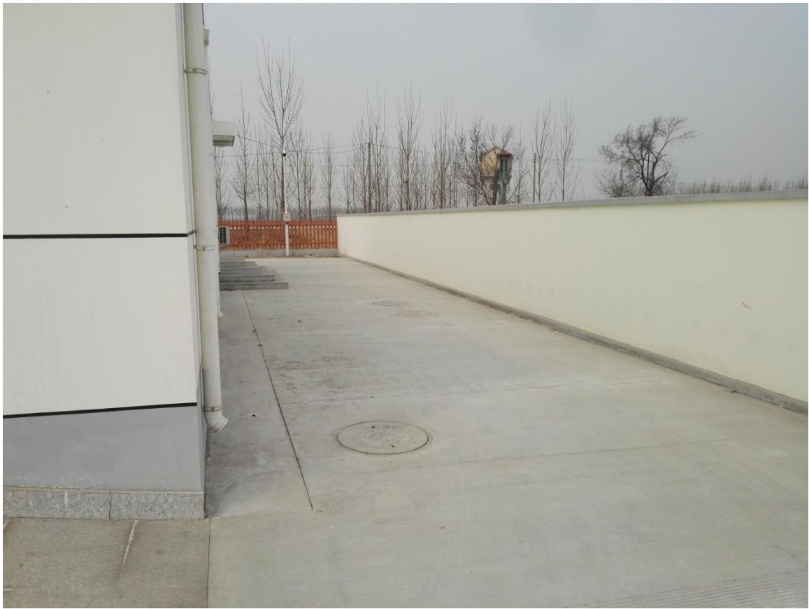
闸管所生活污水化粪池
